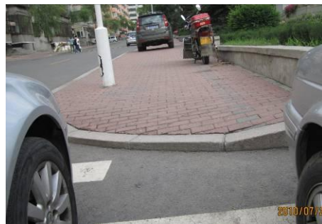
圖 10 體育館旁緣石坡道過高
