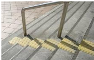
圖 18 樓梯設置盲磚及扶手
